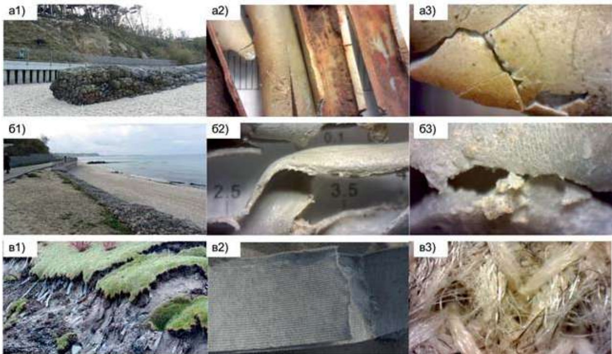
Рис. 5. Геосинтетические материалы на берегах у г. Пионерского: а1–а3 и б1–б3 — габионы с металлической сеткой, покрытой полимерным покрытием со следами деградации, на пляже и в основании склона, в1–в3 — деформированные геоячейки на размывом склоне. а3, б3, в3 — образцы при увеличении \times 40 (фото Есюковой Е. Е.).
